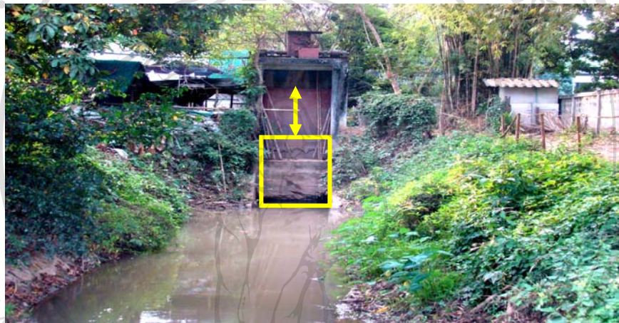
ภาพ 14 แสดงการปิด-เปิด ประตูน้ำเข้าสู่ลำเหมืองท่าศาลาในปัจจุบัน
