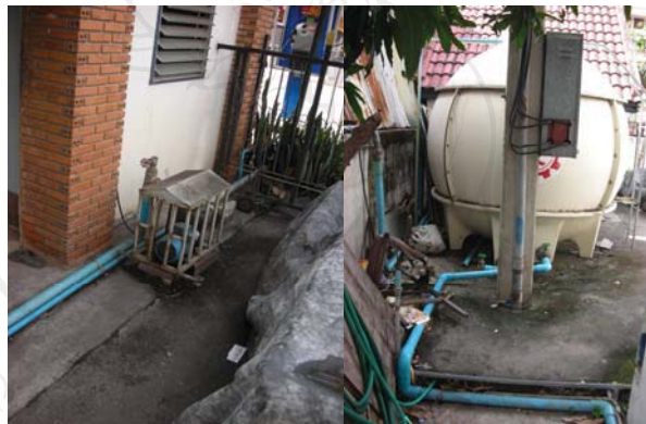
ภาพ 5-27 และ 5-28 สภาพปั๊มน้ำและถังเก็บน้ำของอาคารล้านนา 1
