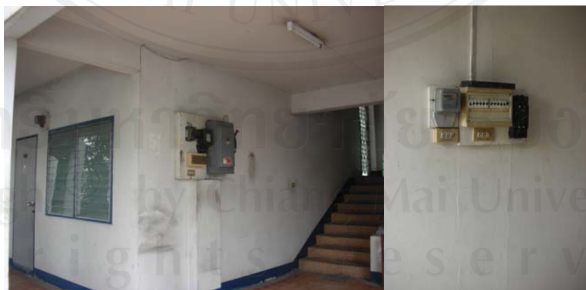
ภาพ 5 – 25 และ 5-26 สายไฟฟ้าและระบบไฟที่ใช้ภายในอาคาร
