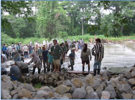
ภาพ 4.18 การนำหินบรรจุในกล่องหิน เพื่อซ่อมแซมฝาย
