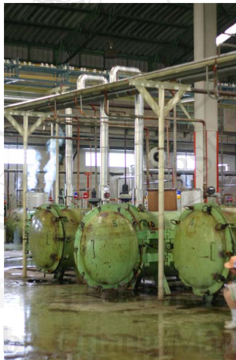
ภาพที่ 4.24 ท่อส่งไอน้ำไปยังหม้อน้ำมาเชื้อหลังหุ้มฉนวน
