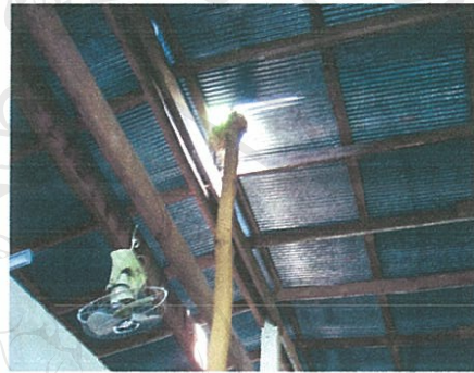
รูปที่ 4.33 รอยรั่วบริเวณหลังคา
