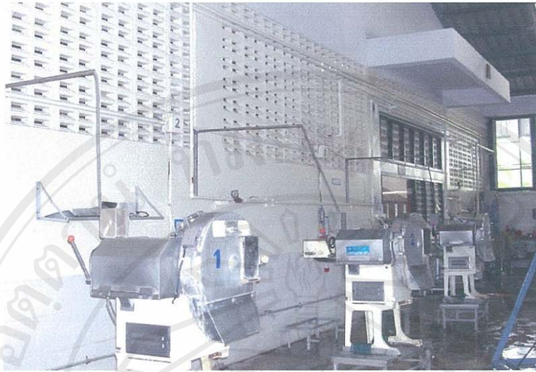
ภาพที่ 4.8 อุปกรณ์ติดตั้งในตำแหน่งที่สามารถทำความสะอาดเข้าถึงได้ และมีความสูงจากพื้น
