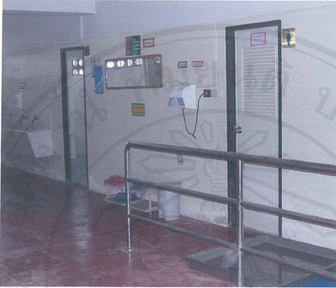
ภาพที่ 4.13 บริเวณล้างมือหน้าห้องน้ำ และมีการติดตั้งอุปกรณ์ล้างมือ
